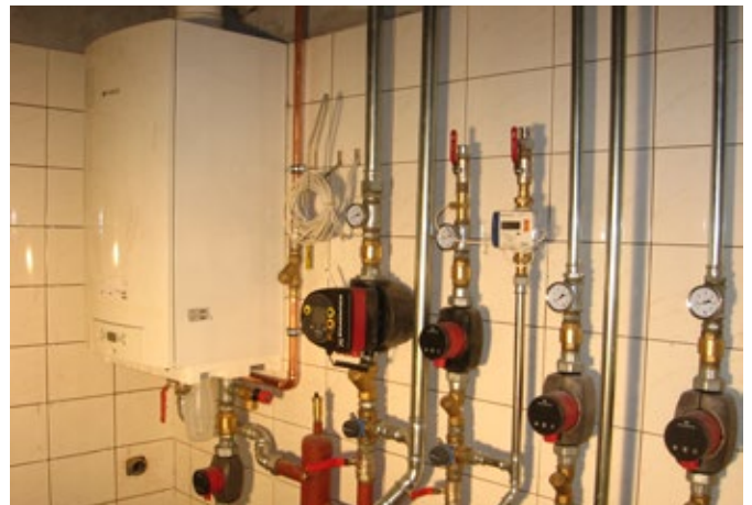
Kotłownia po remoncie
