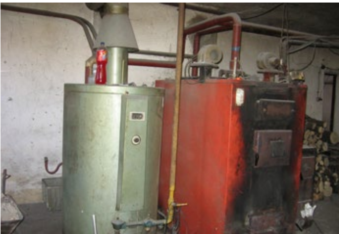
Stara kotłownia w OSP Golezów
